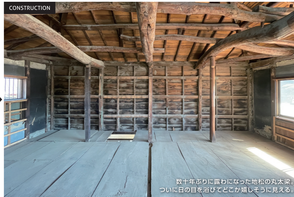
40年程前にリフォームを行ったと想定される室内。 空間は2部屋に間仕切られ、天井板のプリント合板が立派な丸太梁を覆い隠していた。
